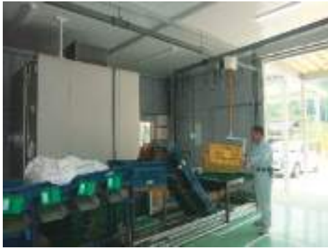
倉庫に設置した天井クレーン
